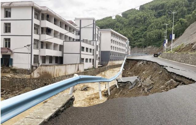
册亨滑坡抢险现场
